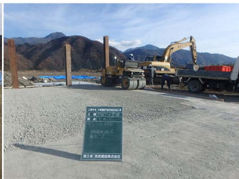
国土交通省関東地方整備局 中部横断不動沢地区平成28年度要対策 汚染土ベントナイト遮水層敷設工事(施工中)
